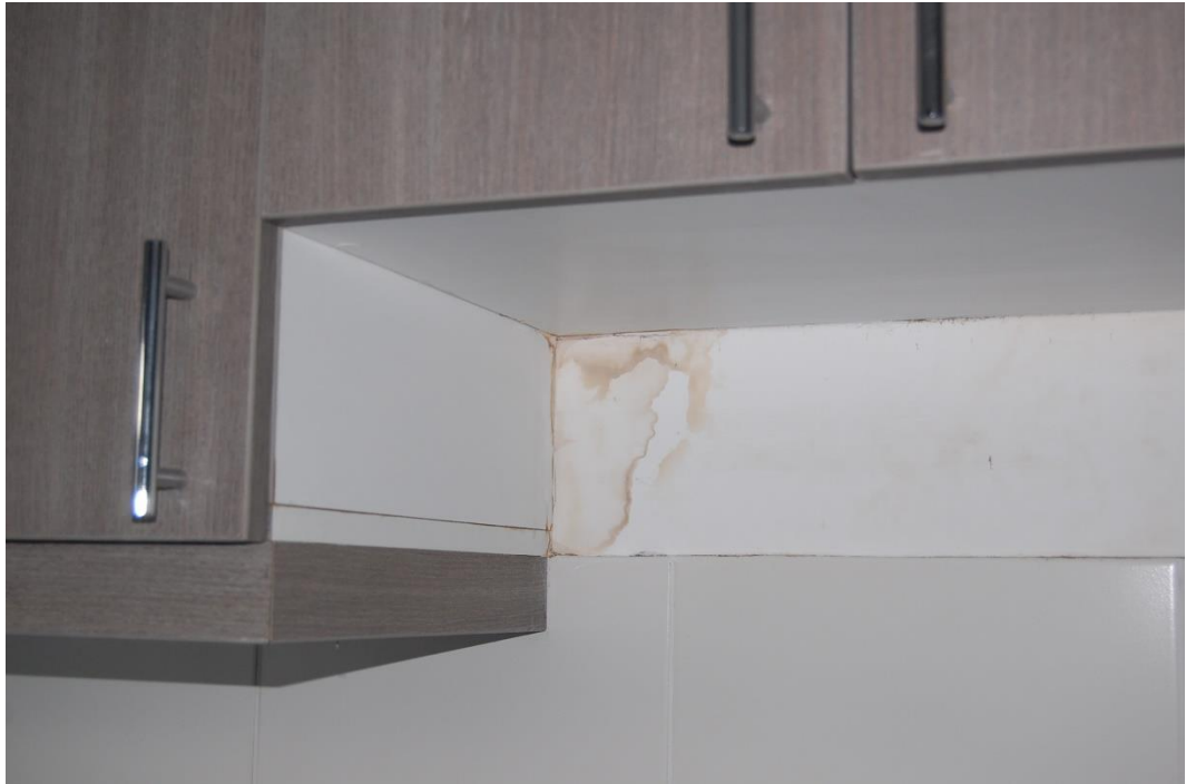
FOTO #5 – UF 3B – MANCHAS DE HUMEDAD EN ZONA ALACENAS
