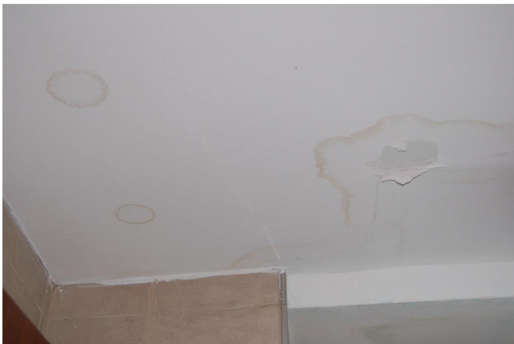
FOTO #13 – UF 4D – REPARACIONES A EFECTUAR EN CIELORRASO BAÑO
