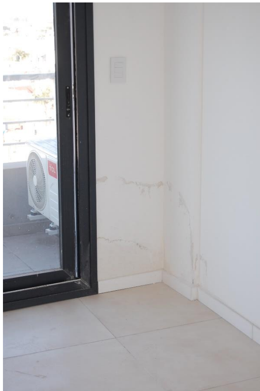
FOTO #8 – UF 8B – MANCHAS DE HUMEDAD
