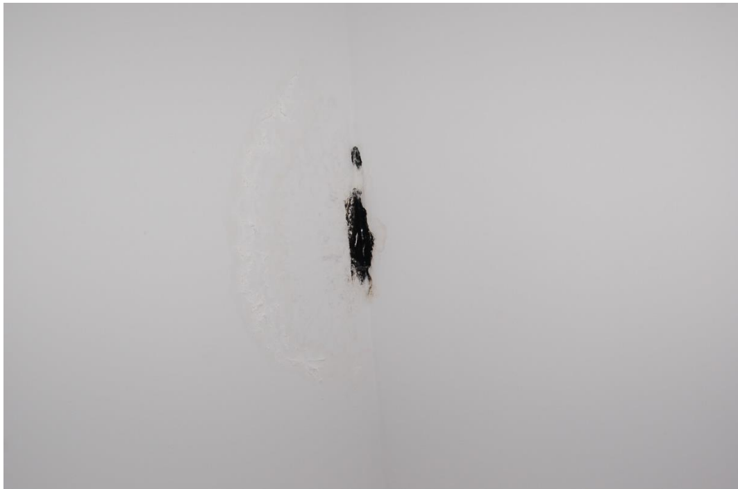
FOTO #10 – UF 4C – HONGOS EN ENCUENTRO TABIQUE-CIELORRASO
