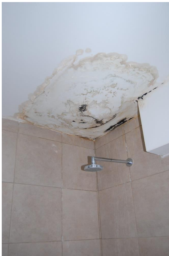
FOTO #11 – UF 4C – CIELORRASO BOMBEADO EN BAÑO
