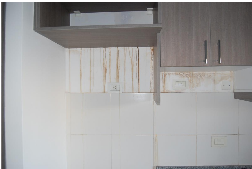
FOTO #2 – UF 3A – MANCHAS OBSERVADAS DETRÁS DE ALACENAS
