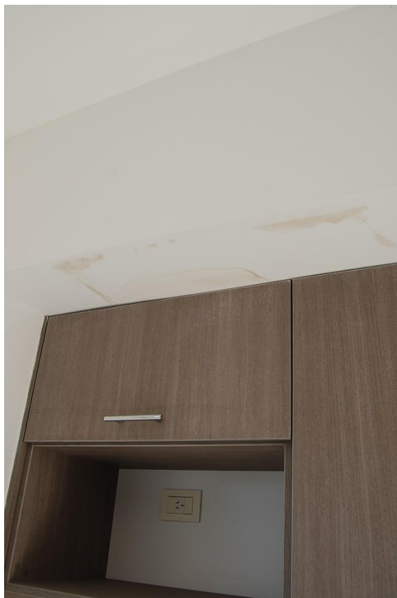
FOTO #17 – UF 5F – MANCHAS DE PROBABLES FILTRACIONES ANTIGUAS
