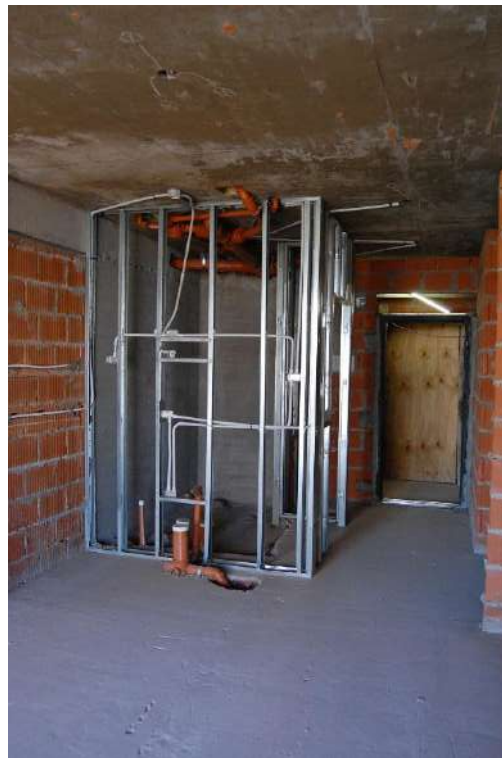
PISO 2° - UF CON ESTRUCTURA DE DURLOCK ARMADA, TENDIDOS ELÉCTRICOS Y DESAGÜES CLOCALES
