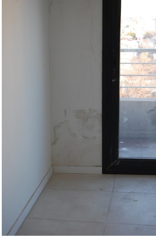
FOTO #7 – UF 8B – MANCHAS DE HUMEDAD
