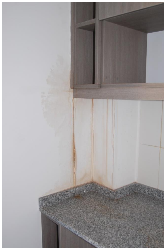
FOTO #19 – UF 8B – MANCHAS EN MURO EXTERIOR
