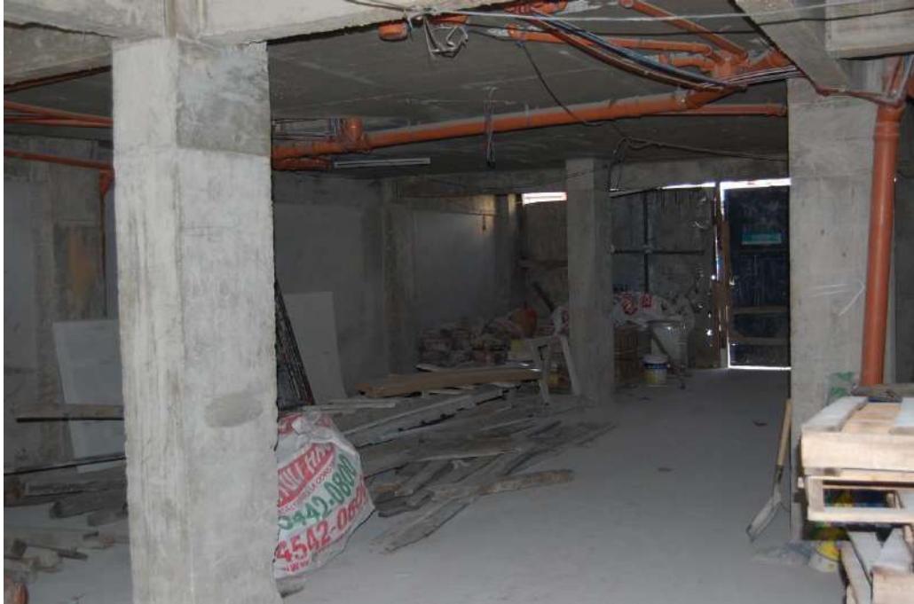
VISTA DEL ESTADO DE LA PB
